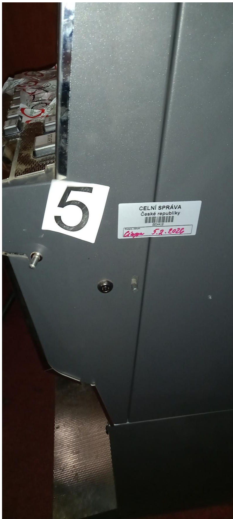
foto č. 50 Detailní fotografie - TZ 5 zámek plomba
